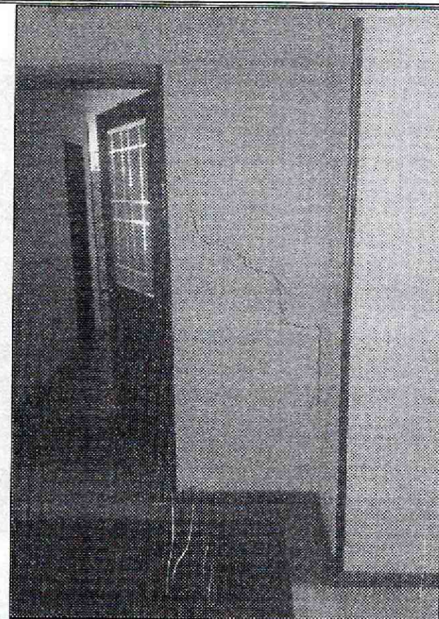
Fotografía 8. Grietas diagonales y verticales identificadas en muros divisorios de algunos apartamentos de las torres de la etapa IV y V, del conjunto residencial Salamanca y Calatayud, ubicadas en el predio de la Carrera 76 No. 145-51, en el Sector Catastral Casablanca de la Localidad Suba.
