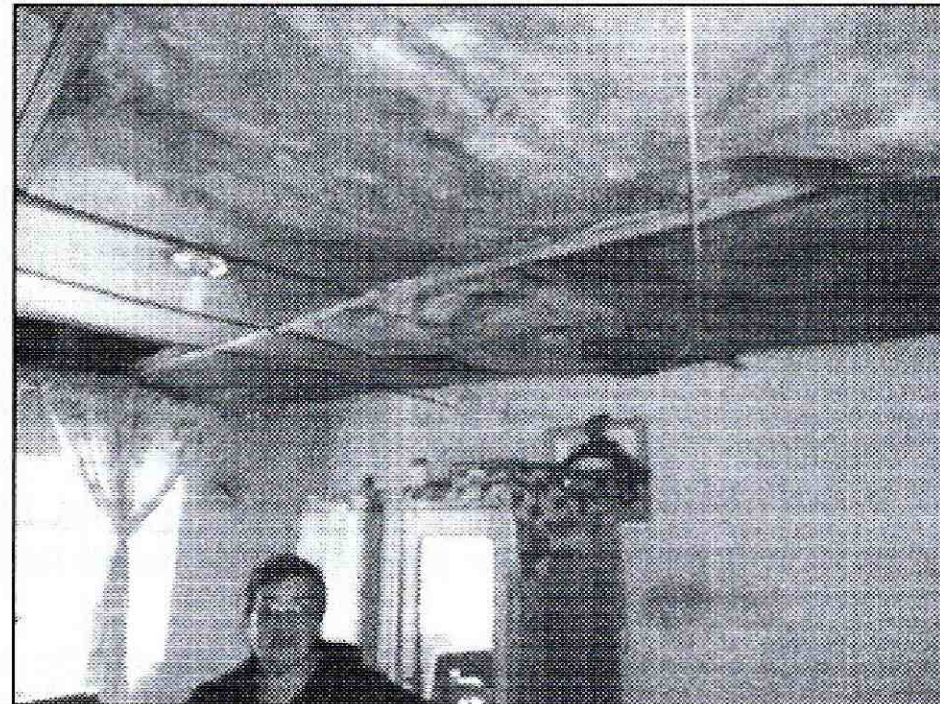
Fotografía 4. Se observa en el cielo raso falso en aglomerado (segundo nivel) presencia de humedades y daños en el cielo raso en aglomerado.
