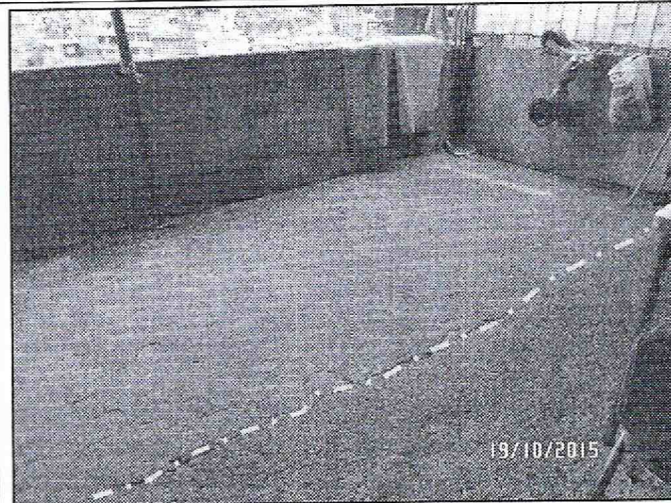
Fotografía 3. Vista de la zona de patio donde se identificó una grieta con longitud cercana a los 3 metros y abertura de aproximadamente 5 milímetros.
