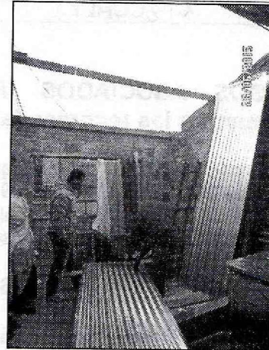
Fotografía 2. Vista del segundo nivel de la vivienda, donde se presentó la pérdida de la cubierta, situación que se originó por un vendaval.
