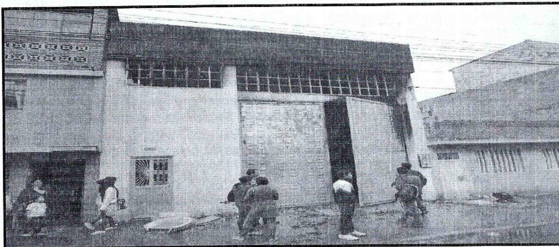
Fotografía 1. Vista general de la fachada de la bodega ubicada en la Transversal 18 C No 47-23 Sur, en el Sector Catastral Santa Lucía de la Localidad de Tunjuelito.
