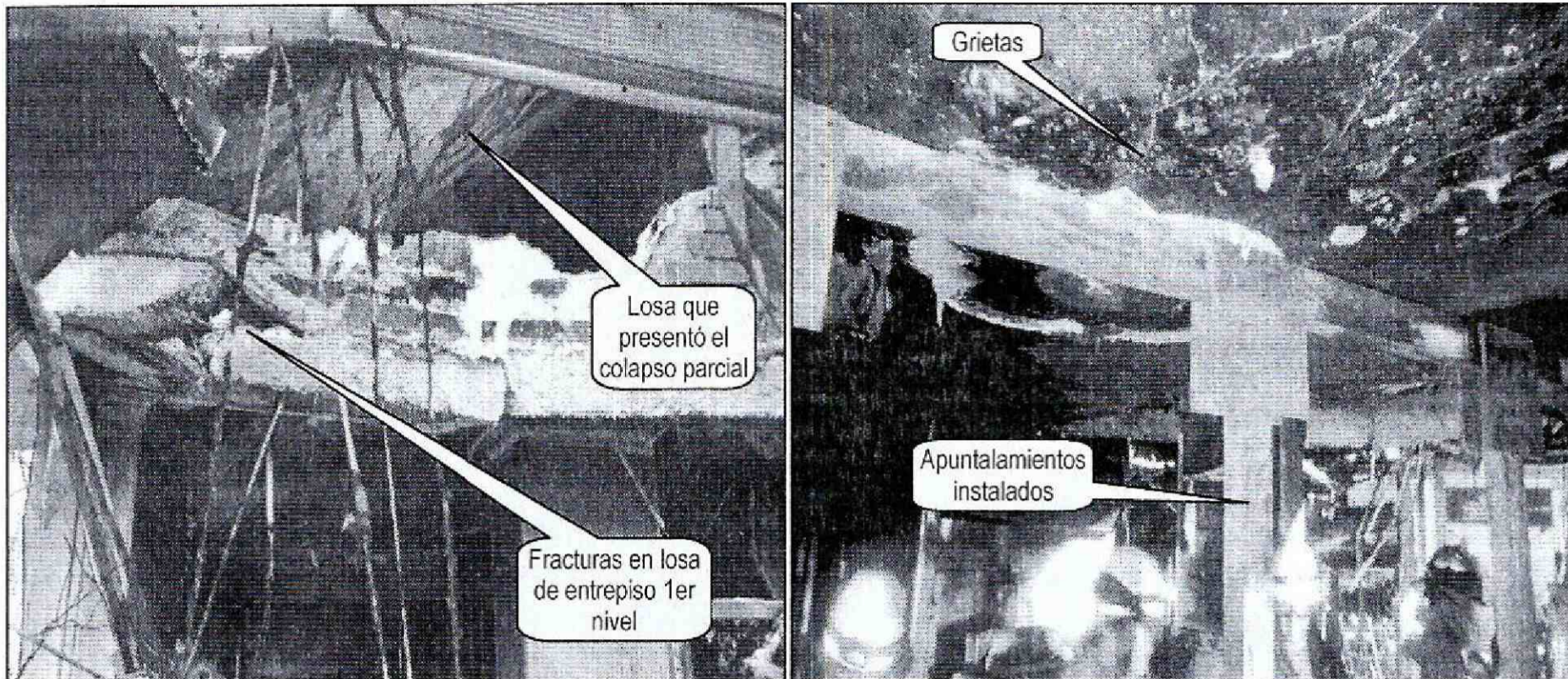
Fotografía 5 y 6. Vista de las afectaciones en losas de entepiso de la edificación emplazada en la Calle 64 F No. 76-42, en el Sector Catastral El Real, de la Localidad de Engativá, así como los apuntalamientos instalados
