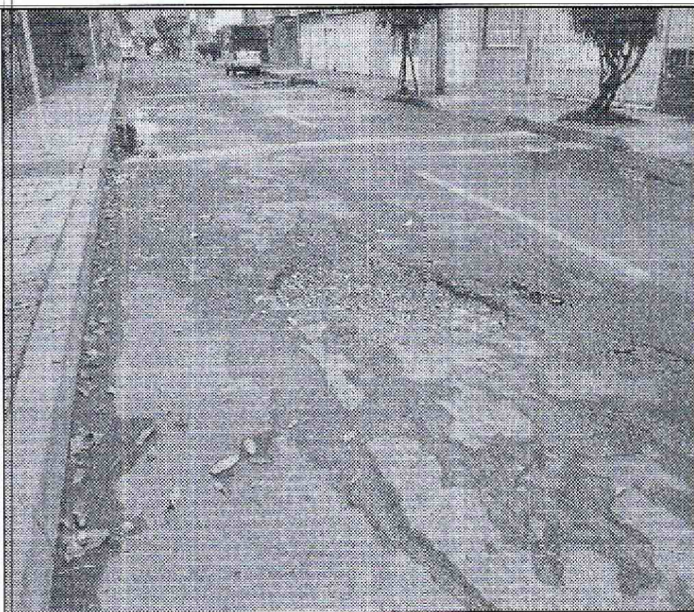
Fotografía 13. Pérdida de material de la estructura del pavimento en algunos puntos de la Calle 90A entre la Carrera 76A y la Carrera 86, en el sector catastral La Serena de la Localidad Engativá.
