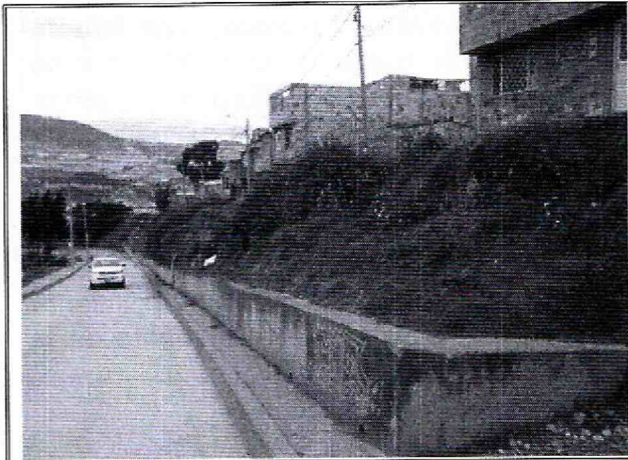
Foto No. 3. Talud de corte, sobre la vía de la Calle 81 Sur entre Carreras 3 Este y 4 Este, en el Barrio el Curubo, de la Localidad de Usme.
