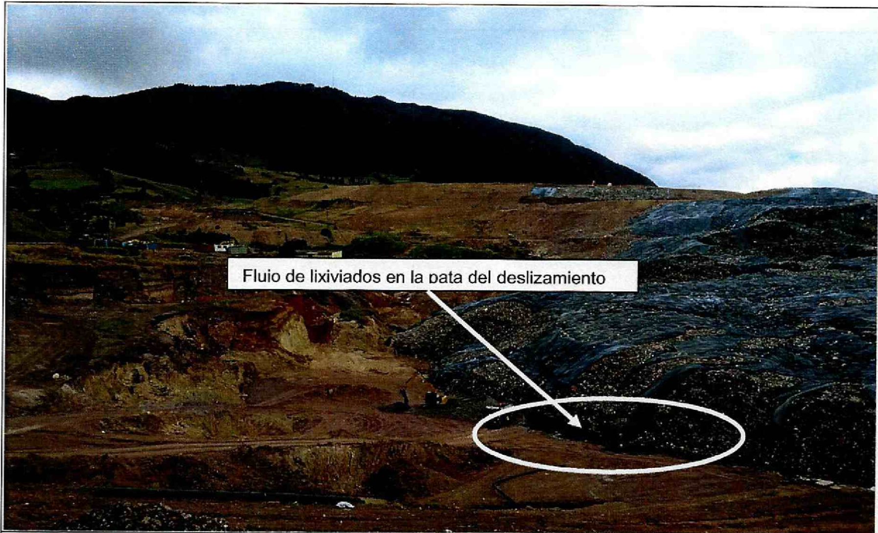
Fotografía 2. Se observó que el material movilizado no se encuentra saturado pero se evidencia la acumulación de flujo de lixiviados en la pata del deslizamiento.
