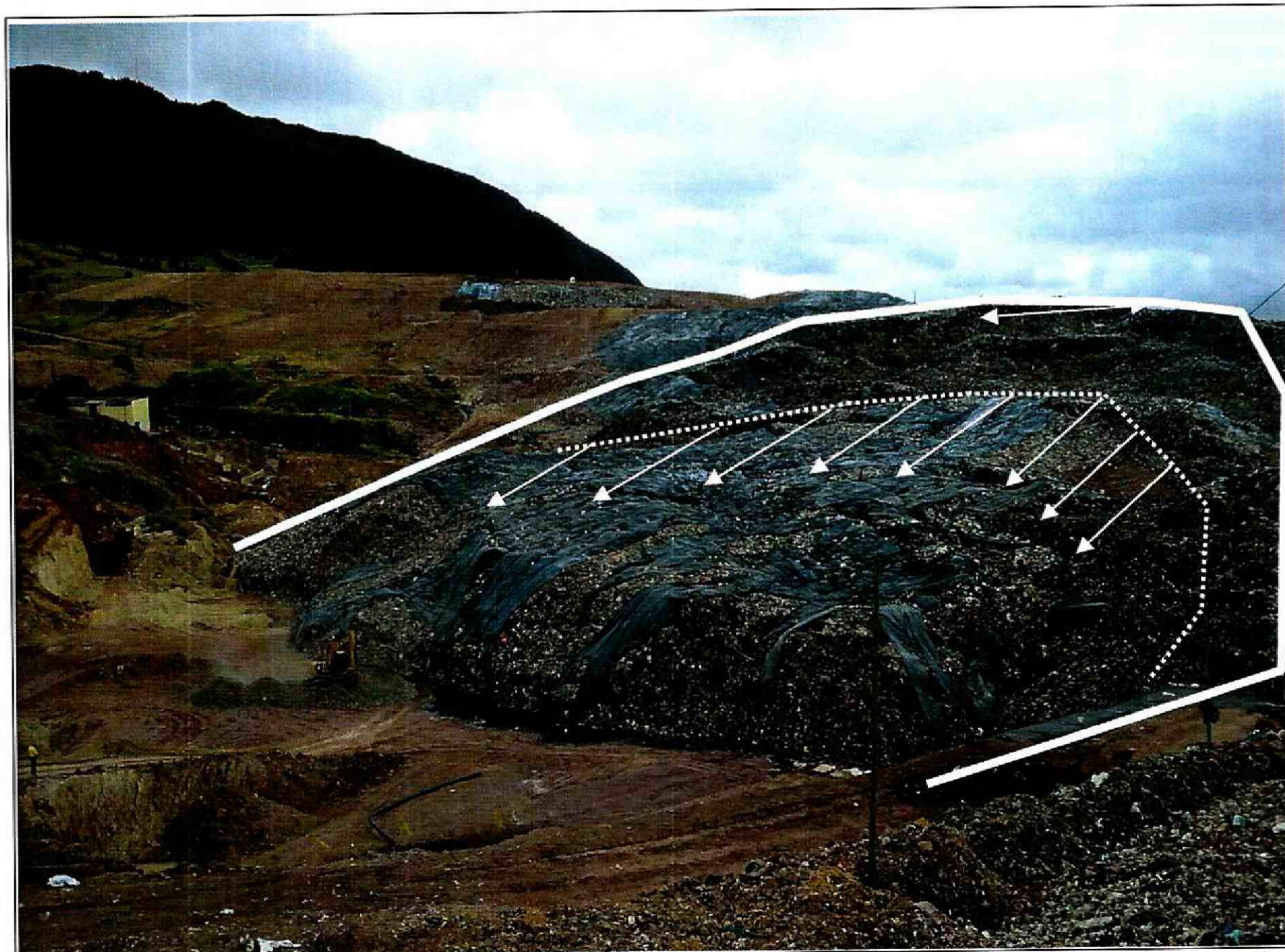
Fotografía 1. Deslizamiento en la zona Optimización Fase II, del relleno sanitario Doña Juana, el proceso de remoción en masa se encuentra caracterizado por un área de afectación de aproximadamente 15000 m 2 un escarpe principal de 10 metros una distancia entre flancos de aproximadamente 300 metros, una movilización de material en una longitud de 120 metros.
