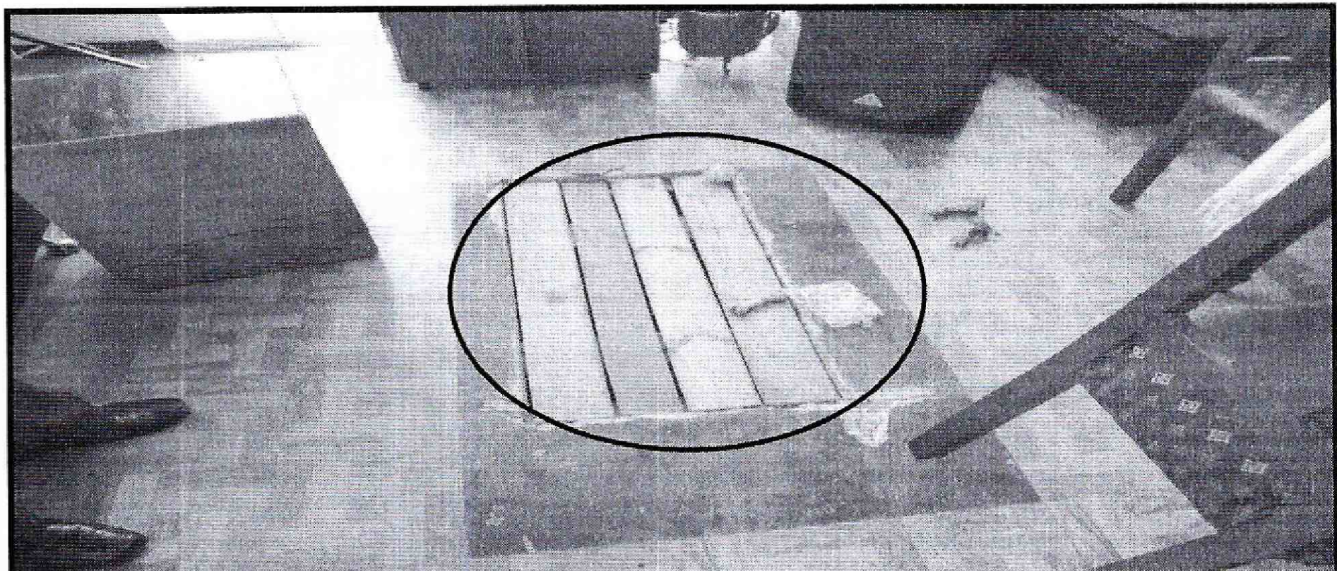
Fotografías 6. Colapso de la plaqueta central, en la losa de contrapiso, localizada el centro de la sala del apartamento 102, interior 8, Bloque 2, en Conjunto Residencial Agrupación de vivienda Pio XII del Sector Catastral Pio XII, en la Localidad de Kennedy
