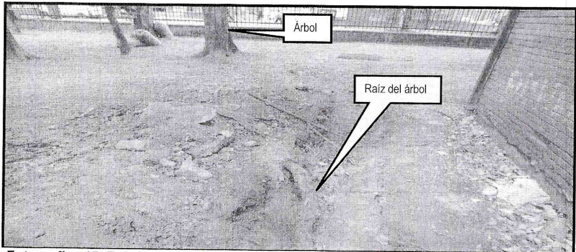
Fotografías 15. Raíz de un árbol encontrada en las cercanías de la fachada sur, del bloque 8 al interior del Conjunto Residencial Agrupación de vivienda Pio XII.
