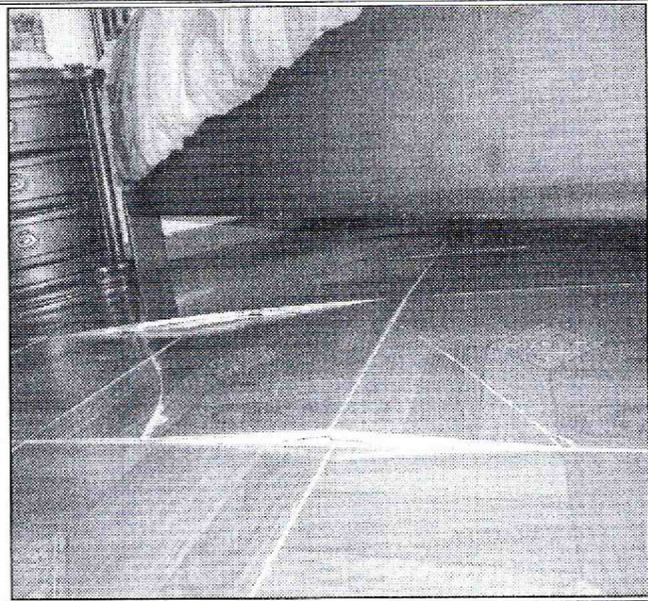
Fotografía 18. Levantamiento de losetas de piso en el apartamento 503 de la torre 12 del conjunto residencial Bosques de la María II, en el Sector Catastral Horizontes Norte de la Localidad Usaquén.
