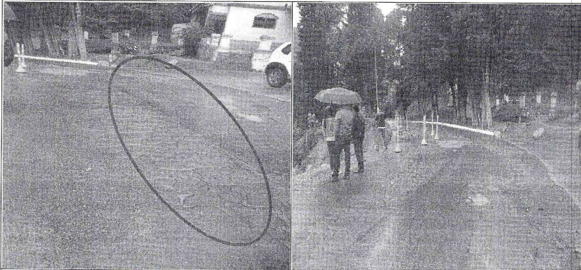
Fotografía 3 y 4. Estructura en material granular con pavimento flexible, en la que adicional a la pérdida de la banca en el sector antes mencionado se observan grietas en bloque, piel de cocodrilo y grietas de tendencia transversal y longitudinal.
