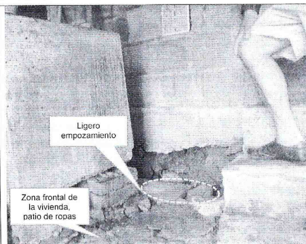
Fotografía 4. Vista de la zona de lavado de ropas, en la parte frontal de la vivienda, se aprecia en la base de la viga cimiento un leve empozamiento.
