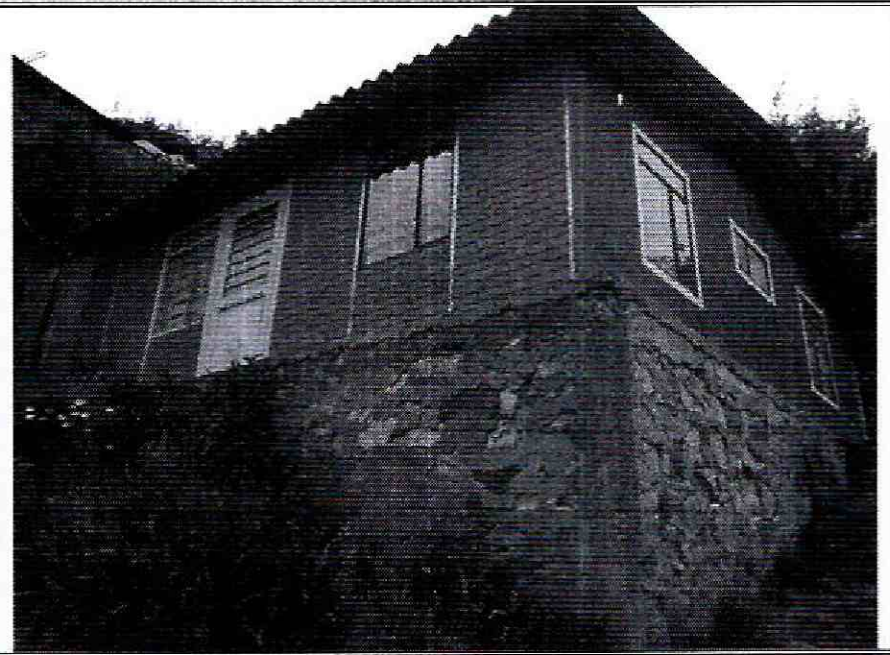
Foto No. 6. Muro en piedra pegada, sobre los costados norte y occidental, de la vivienda No. 2. Emplazada en la Carrera 10 D Bis Este No. 81 C – 16 Sur, en el sector catastral de La Esperanza del Sur I - Localidad de Usme.
