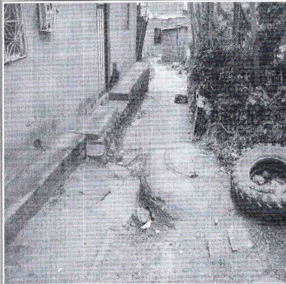
Foto No. 1. Vista via de acceso y humedades en el sector de la Diagonal 77 D Sur No. 18G - 24
