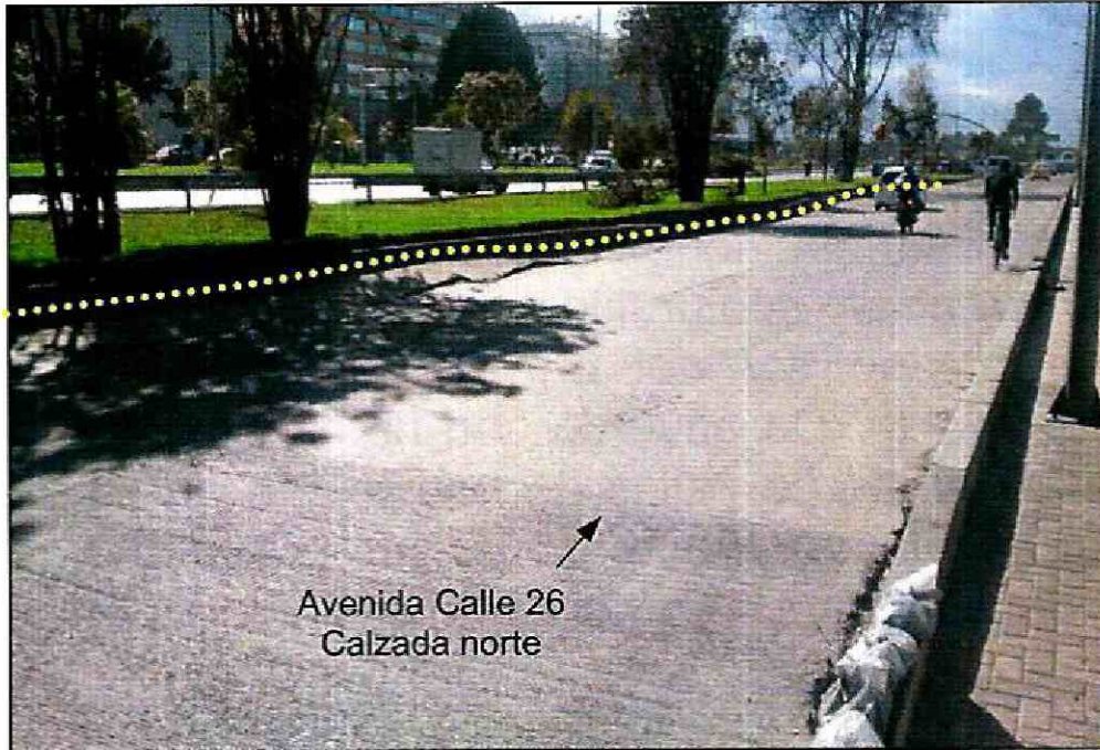
Fotografía 1. Ondulaciones y hundimientos observados hacia el carril izquierdo de la calzada norte de tráfico lento de la Avenida Calle 26, entre la Carrera 69 y la Carrera 69D, en el sector catastral Jardín Botánico de la Localidad Engativá.
