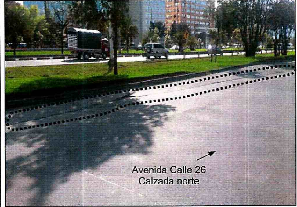
Fotografía 2. Fracturas observadas en las losas de pavimento del carril izquierdo de la calzada norte de tráfico lento de la Avenida Calle 26, entre la Carrera 69 y la Carrera 69D, en el sector catastral Jardín Botánico de la Localidad Engativá.
