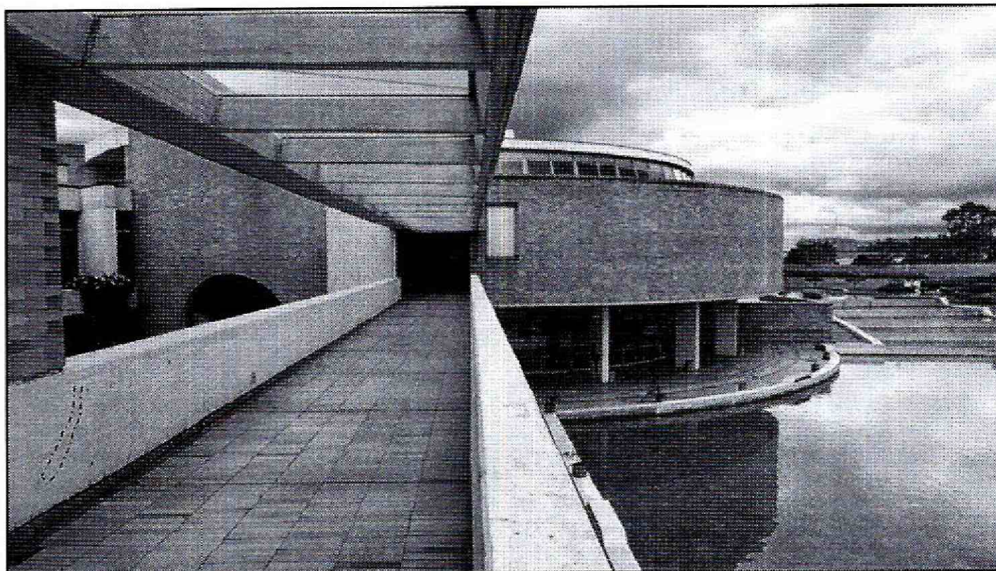
Fotografía 5. Vista de una de las vigas nororientales que presentan fisuras leves diagonales en una de las rampas de la Biblioteca Pública Virgilio Barco, emplazada en el predio de la Avenida Carrera 60 No. 57 - 60, en el Sector Catastral Pablo VI, de la Localidad de Teusaquillo
