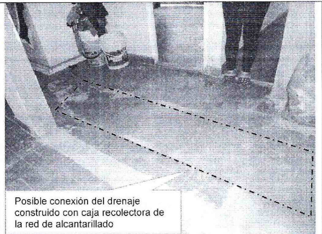
Fotografía 4. Posible conexión del drenaje construido con caja recolectora de la red de alcantarillado hacia el sector central de la vivienda de la Carrera 5 No. 81-70 Sur.
