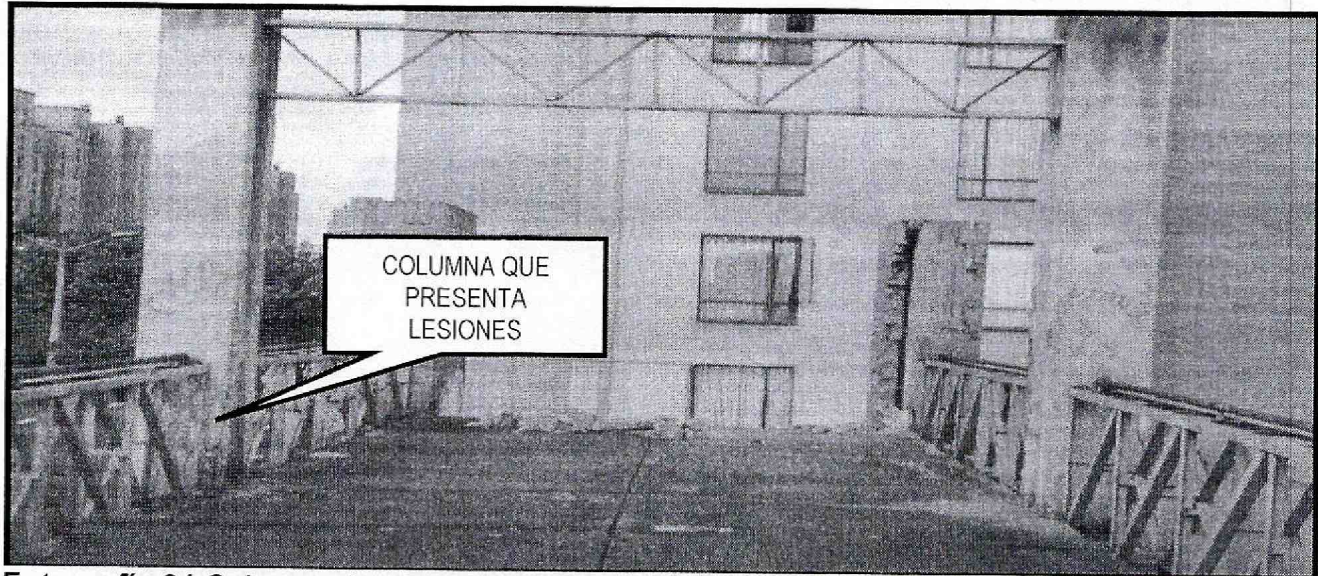
Fotografía 21. Columna que presenta desprendimientos del recubrimiento al nivel de la placa de concreto por donde circulan los usuarios del puente peatonal.
