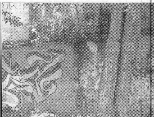
Fotografía 2. Se aprecia al costado oriental del predio de la Carrera 49 No. 163B-17, que entre los muros adosados se localiza un arbusto de tamaño mediano, el cual posiblemente está generando empuje al muro y las afectaciones que se aprecian en el mismo.
