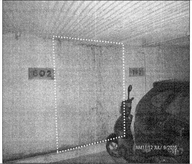
Fotografía 4. Marcas dejadas en las pantallas de los sótanos del Edificio Alcaraván, ubicado en el predio de la Calle 106 No. 7-60, en el sector catastral Santa Ana Occidental de la Localidad Usaquén, producto de filtraciones de agua.
