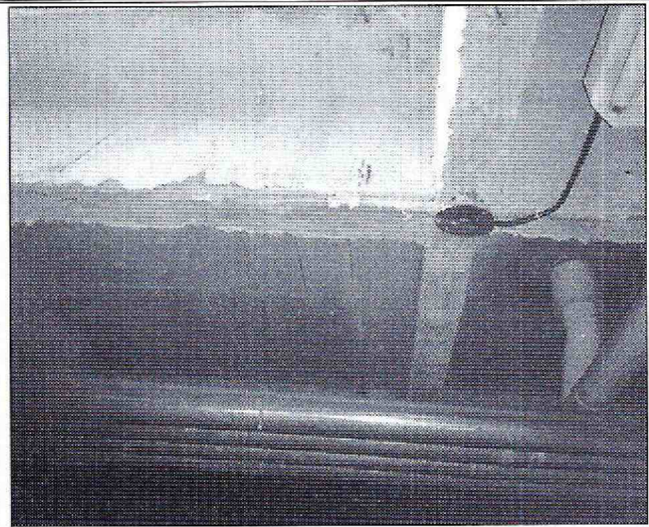
Fotografía 10. Instalaciones eléctricas que se ubican entre la sección de la viguetería de la plataforma de estacionamiento del conjunto residencial Parque de los Cerezos 1ª y 2ª Etapa, ubicado en el predio de la Calle 137 No. 91-97, en el sector catastral Villa Elisa de la Localidad Suba.
