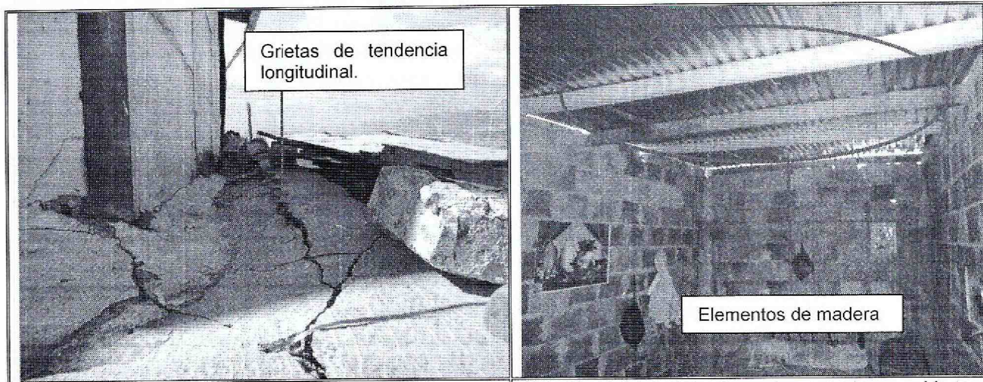
Foto No. 3. Grietas en la placa de concreto al costado occidental de la vivienda de la Calle 82B No. 18Q-40. Barrio Arabia de la Localidad de Ciudad Bolívar. Foto No. 4. Vista del entramado en madera y cubierta, en el predio de la Calle 82B No. 18Q-40, Barrio Arabia de la Localidad de Ciudad Bolívar.
