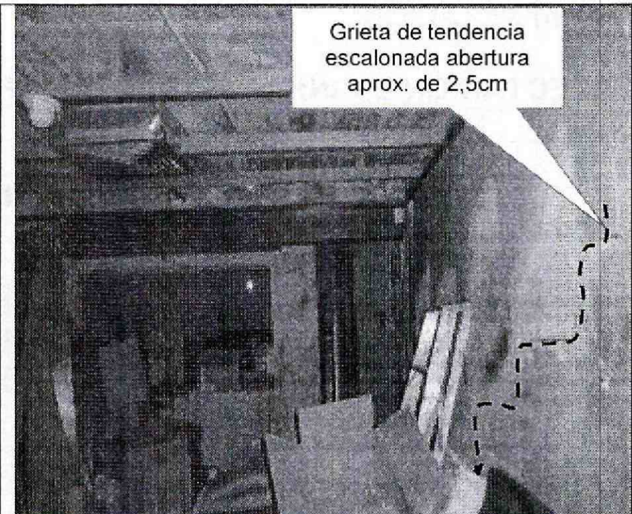
Fotografía 6. Grietas de tendencia diagonal y horizontal, de longitud entre 0.5 y 2m, con abertura entre 0,1 y 3cm en muro de cerramiento, primer nivel, costado Nor-occidental de la edificación 2.
