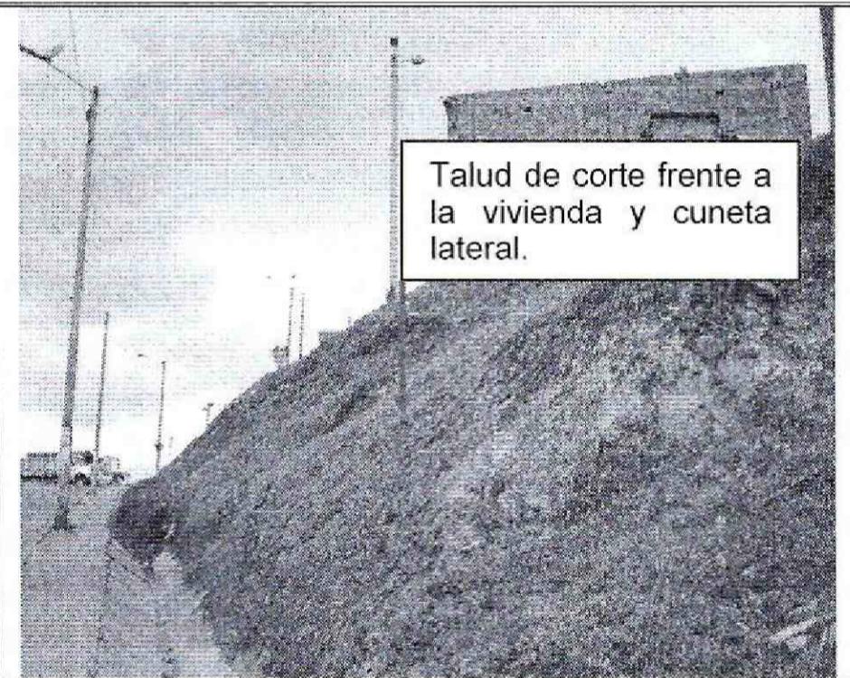
Foto No. 4. Talud frente a la vivienda de la Calle 69 N Sur No. 44 A - 40.
