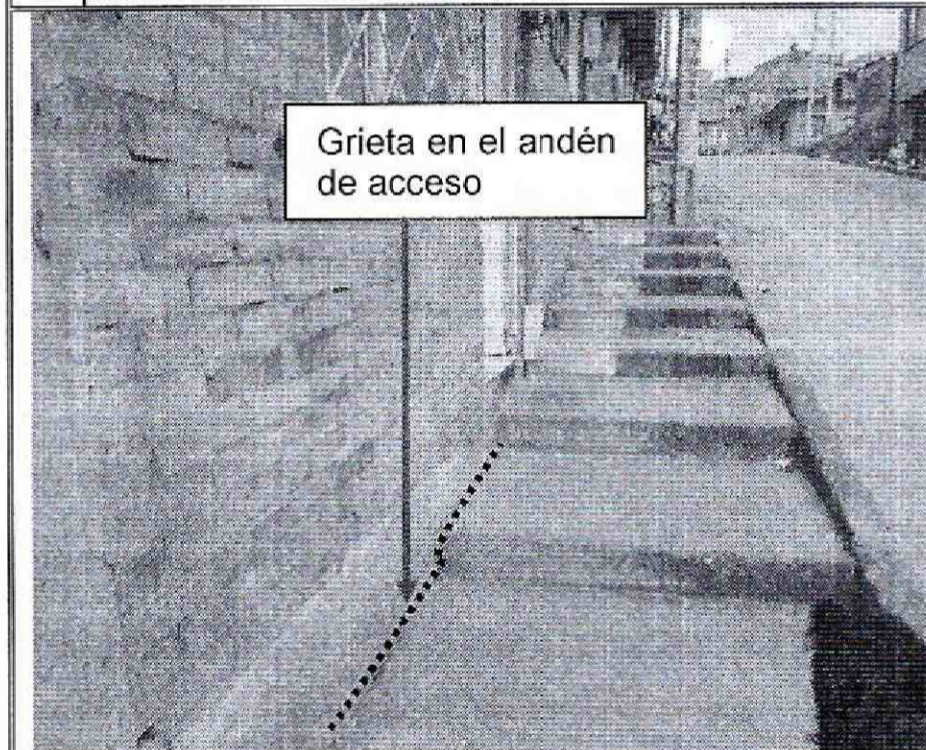
Foto No. 3. Grieta en el andén que sirve de acceso a la vivienda, de la Calle 69 N Sur No. 44 A - 40.
