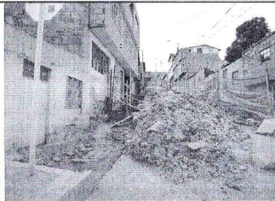
Foto No. 4. Obras de construcción vial de la Cra 18H. Barrio Estrella del Sur. Localidad de Ciudad Bolívar.
