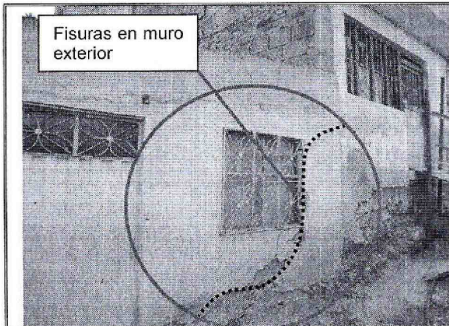
Foto No. 3. Fisuras en el muro exterior de la vivienda. Cra. 18H Bis No. 70 – 06 Sur, Barrio Estrella del Sur. Localidad de Ciudad Bolívar.
