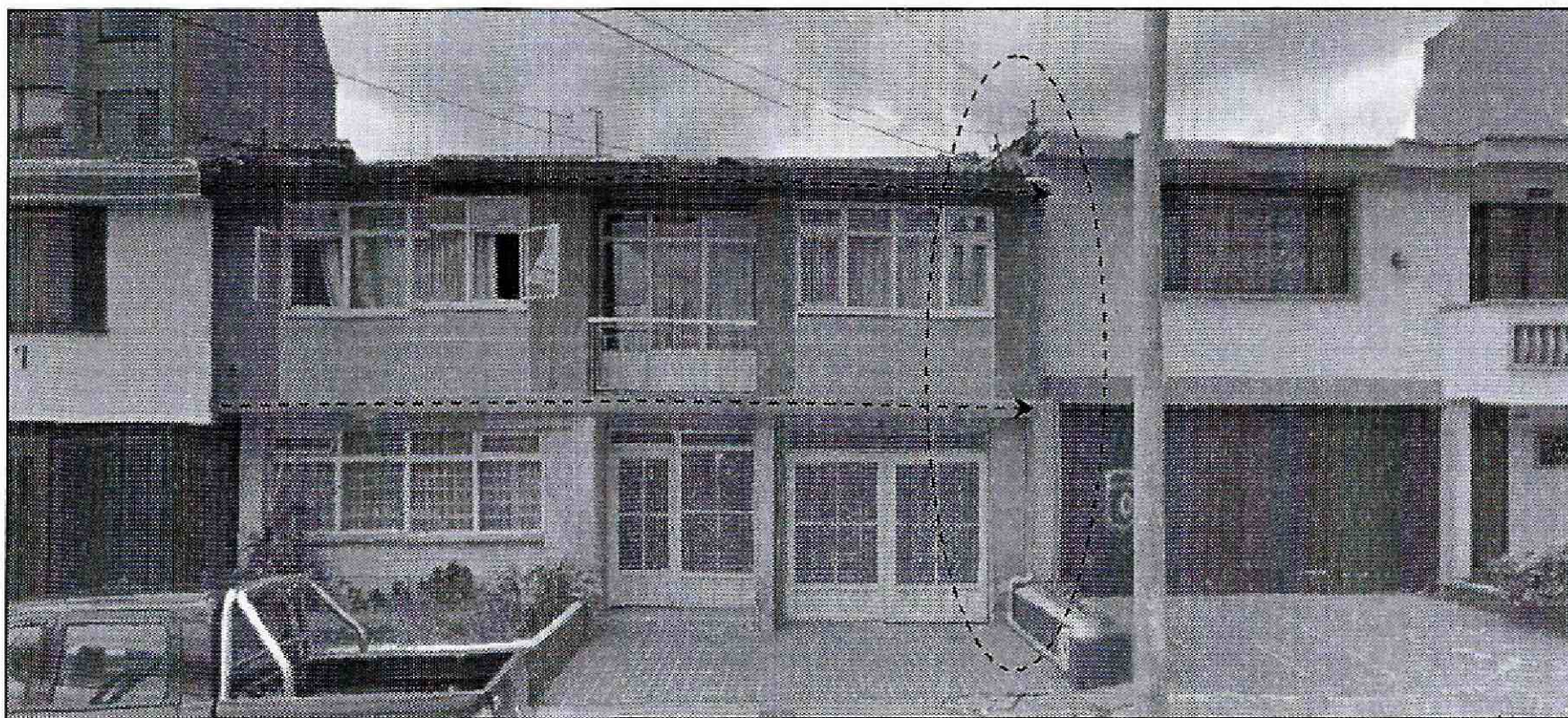
Fotografía 1. Vista de la fachada del predio ubicado en la Carrera 27A No. 49A-10 del Sector Catastral Alfonso López de la Localidad de Teusaquillo, donde se observa la pérdida de horizontalidad de la vivienda.
