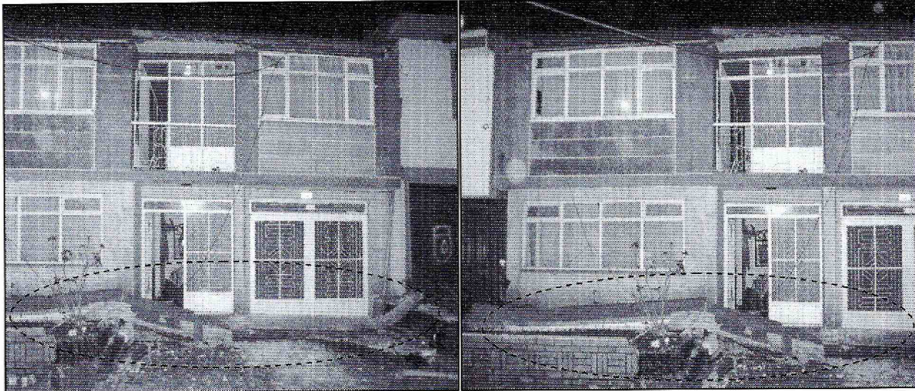
Fotografía 2 y 3. Vista del colapso de la cornisa del segundo nivel de fachada del predio ubicado en la Carrera 27A No. 49A-10 del Sector Catastral Alfonso López de la Localidad de Teusaquillo
