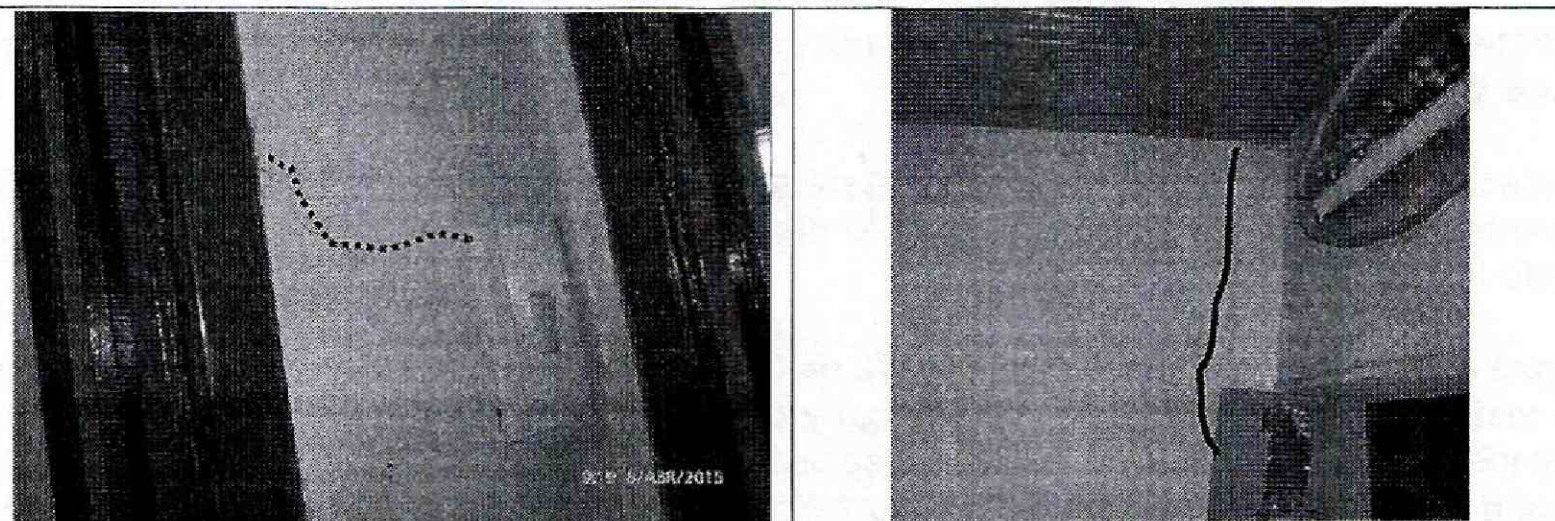
Fotografía 2, 3: se observan fisuras en los muros de divisorios de tendencia escalonada, con longitudes que oscilan entre los 5 centímetros y 20 centímetros y aberturas entre 1 y 2 milímetros, en el predio de la Carrera 25 N° 68-74, en el Sector Catastral Alcázares de la Localidad de Barrios Unidos.
