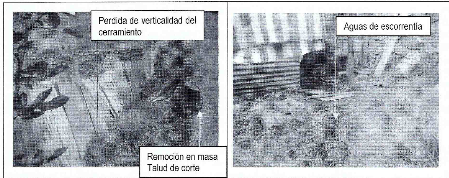
Fotografía 1 y 2. Sector de remoción del talud de corte, pérdida de verticalidad del cerramiento en teja de zinc y sector del patio posterior de la vivienda donde discurren las aguas de escorrentía del predio ubicado en la Cra 18 Bis A No. 78 – 27 Sur. Barrio Bogotá II Sector de la Localidad de Ciudad Bolívar.
