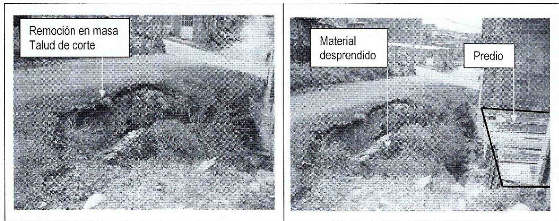
Fotografía 3 y 4. Sector de remoción del talud de corte, en la vía y lote con cerramiento en teja de zinc del predio ubicado en la Cra 18 Bis No. 78 – 20 Sur. Barrio Bogotá II Sector de la Localidad de Ciudad Bolívar.
