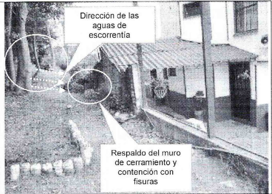
Fotografía 8. Vista del respaldo del muro de cerramiento del costado oriental, dirección de las aguas de escorrentía y residuos varios, que facilitan la infiltración en el muro en mampostería que presenta fisuramiento hacia el interior.
