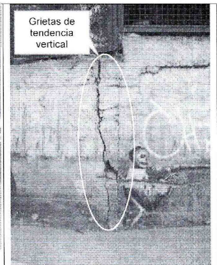
Fotografía 11. Grieta de tendencia vertical con aberturas entre 1 y 3 cm, en muro de cerramiento que da a la Calle 169B.
