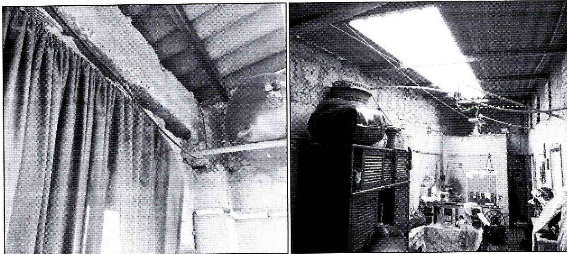
Fotografía 2 y 3. Vista del interior de la vivienda de la Calle 136A No. 159-07 del Sector catastral Santa Cecilia II Sector de la Localidad de Suba, la cual no presenta lesiones
