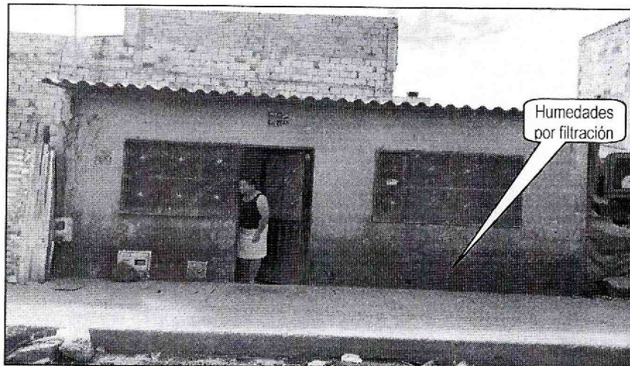
Fotografía 1. Fachada principal del Predio ubicado en la Calle 136A No. 159-07 del Sector catastral Santa Cecilia II Sector de la Localidad de Suba
