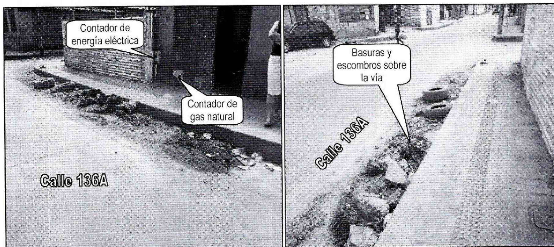
Fotografía 4 y 5. Vista del andén y de la Calle 136A, donde se pueden ver los escombros y basuras acumulados, muy posiblemente arrastrados por aguas superficiales.
