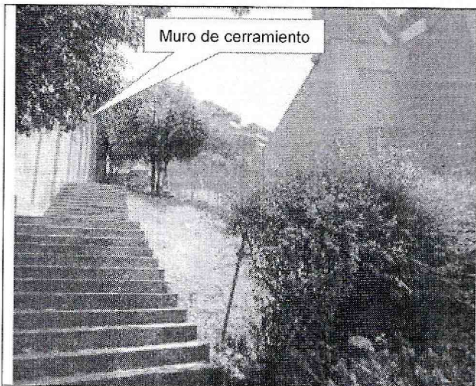
Fotografía 1. Vista del muro de cerramiento del costado Sur-oriental del predio de la Calle 127A Bis No. 5B-27 INT 3, barrio Las Delicias del Carmen de la Localidad de Usaquén.
