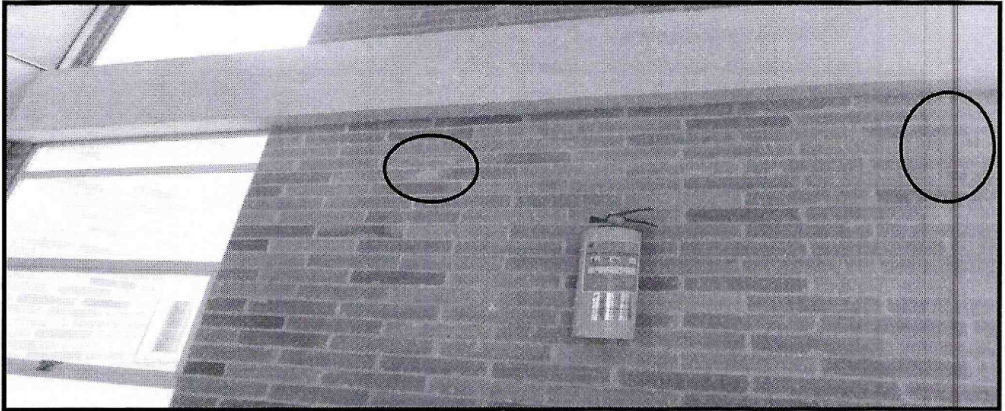
Fotografía 9. Aparición de humedades en la mampostería de los pasillos del edificio
