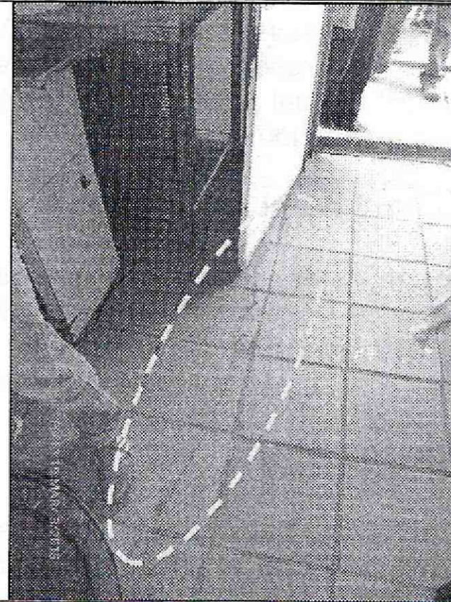
Fotografía 6. Fisura identificado en pisos del predio de la Calle 143B No. 150B-21, en el barrio Bilbao II Sector Sección A-B-C-D-E, de la localidad de Suba, producto de hundimientos que se presentan en el mismo por asentamientos diferenciales en el predio de la Carrera 150C No. 143-72.
