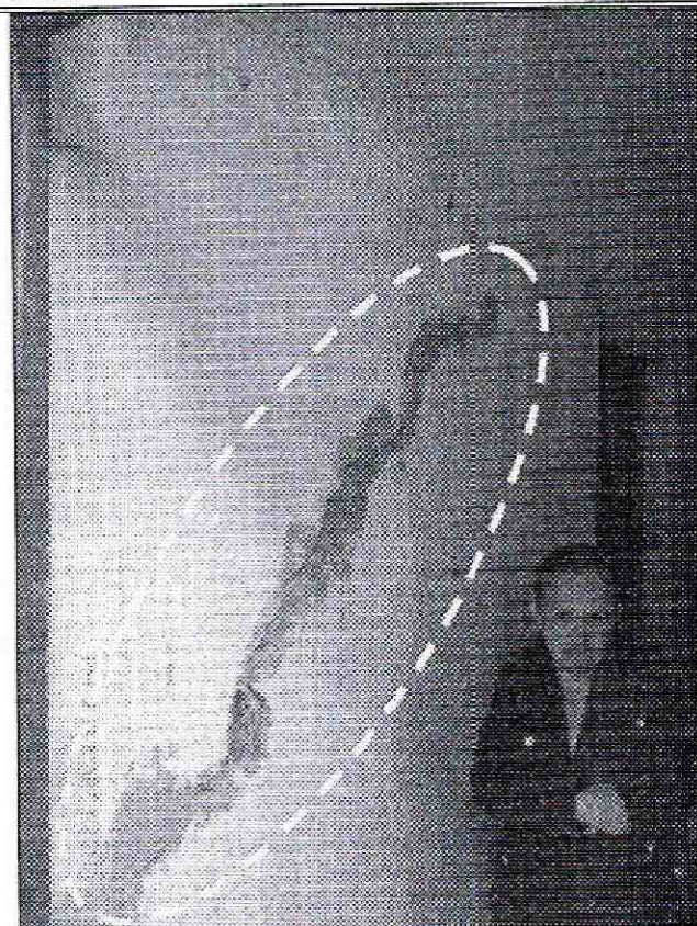
Fotografía 3. Grieta identificado en uno de los muros divisorios en el predio de la Calle 143B No. 150B-21, en el barrio Bilbao II Sector Sección A-B-C-D-E, de la localidad de Suba, y que es colindante con el predio de la Carrera 150C No. 143-72.
