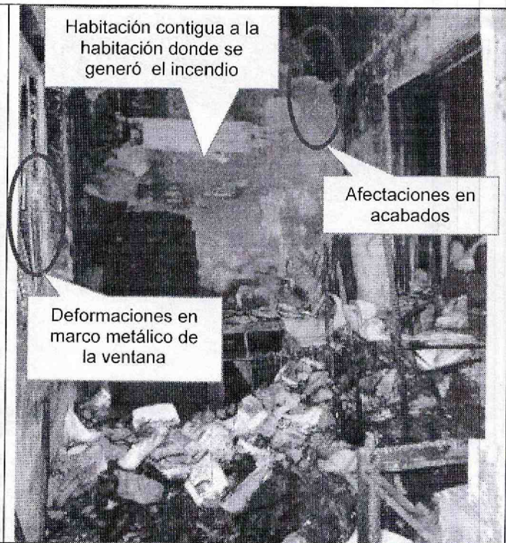
Fotografía 2. Habitación contigua a la habitación donde se generó el incendio, en la cual se afectaron los acabados, también se aprecia la deformación del marco metálico de la ventana y enseres incinerados.
