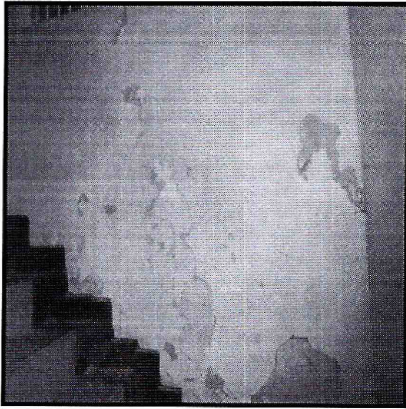
Fotografía 12. Desprendimiento de pintura en los muros de las escaleras en todos los niveles.
