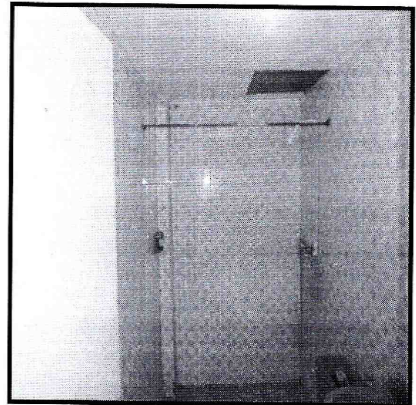
Fotografía 7. Baño del apartamento desocupado del segundo nivel
