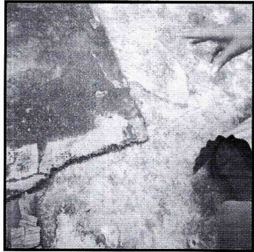
Fotografía 18. Fisuras de tendencia longitudinal en la torta superior de la placa de cubierta en la terraza.
