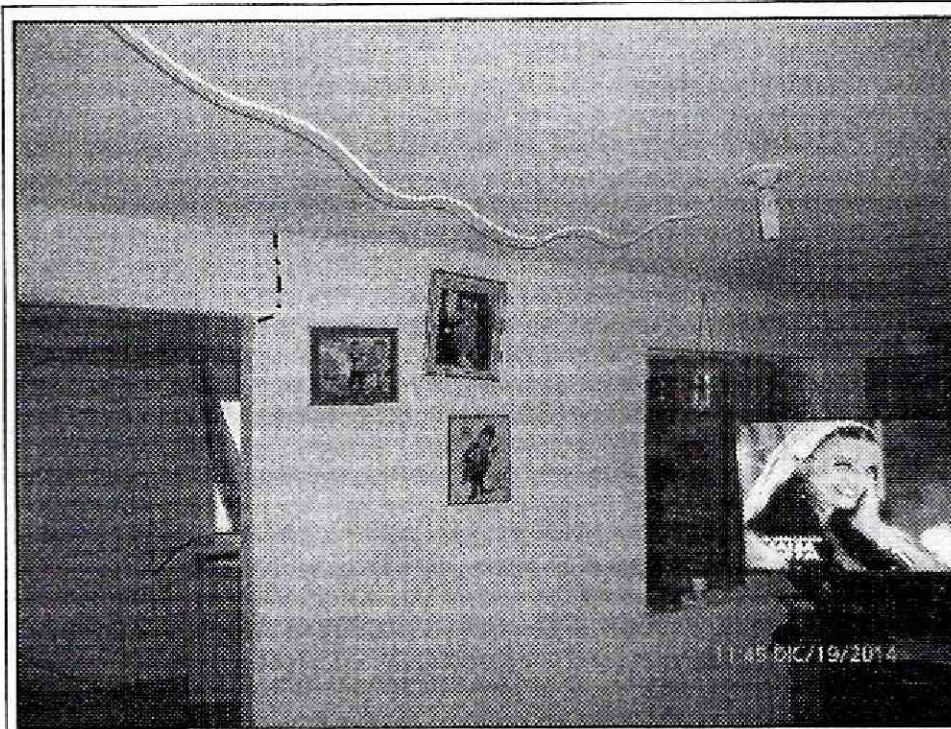
Fotografía 3. Vista de uno de los muros divisorios de la vivienda evaluada en el que se identificó la presencia de una fisura de tendencia vertical con longitud cercana a 0.40 metros y abertura de aproximadamente 2 milímetros, la cual no compromete la estabilidad estructural y funcionalidad de dicho espacio.
