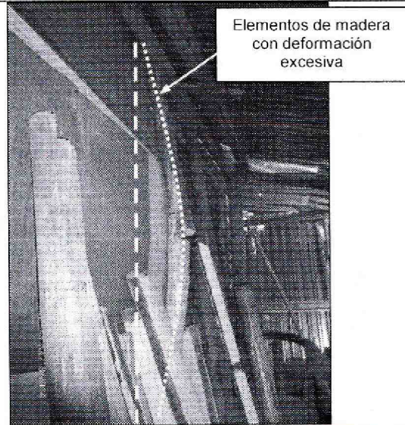
Fotografía 6. Vista de uno de los elementos que dan soporte a los cerramientos y cubierta del costado Occidental de la vivienda ubicada en el predio de la Carrera 10A Bis Este No. 89-31 Sur, en donde se aprecia la deformación excesiva que presenta.
