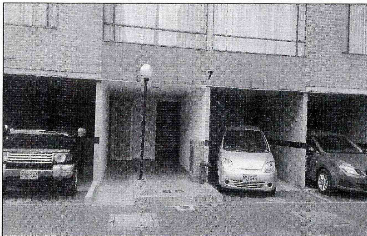
Fotografía 3. Vista del primer piso de la Torre 7 del Conjunto Residencial Oviedo ubicado en la Calle 12A No. 71C-20 del Sector Catastral Villa Alsacia de la Localidad de Kennedy, donde no se observan afectaciones
