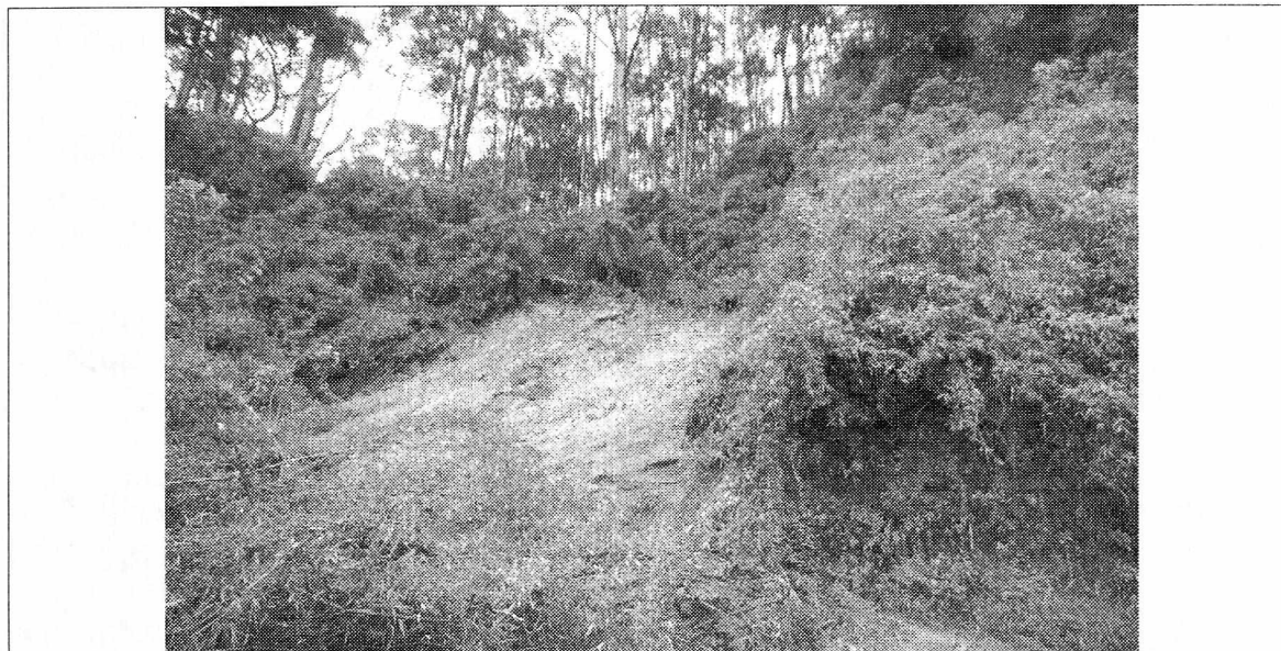
Foto 3. Talud de corte vial ubicado en el aproximadamente en el punto con coordenadas 4°29'35.16" N / 74°04'54.57" O, Kilómetro 0 Antigua Vía el Llano, Vereda Los Soches, en la Localidad de Usme, talud que no cuenta con medidas de estabilización y/o contención ni sistemas para el manejo de las aguas de escorrentía superficial o subsuperficial.
