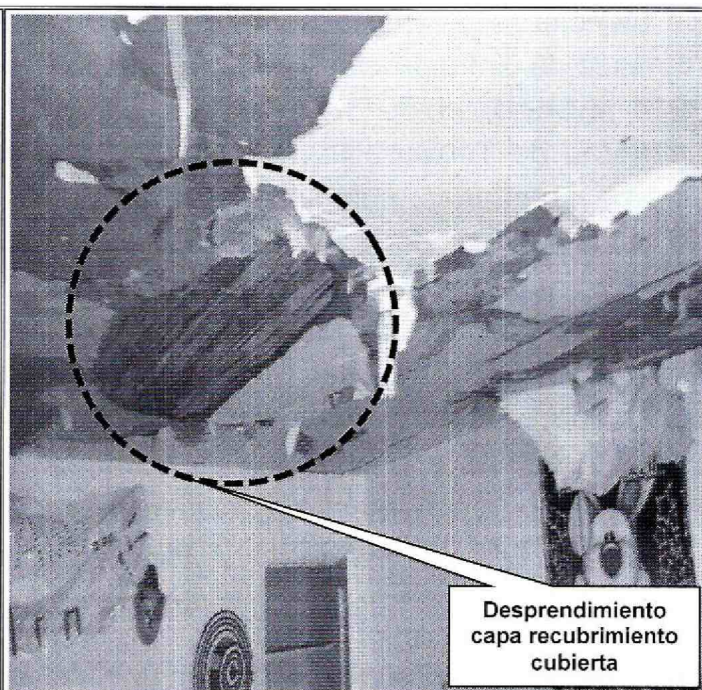
Foto No. 2 vista interior de la vivienda. Desprendimiento capa recubrimiento cubierta en habitación costado sur, aproximadamente 2.5 m 2
