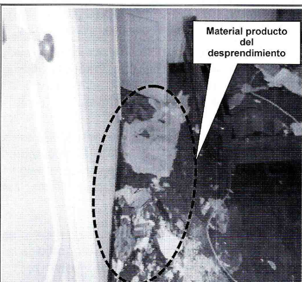
Foto No. 4 Vista interior de la vivienda. Material producto del desprendimiento en habitación segundo piso
