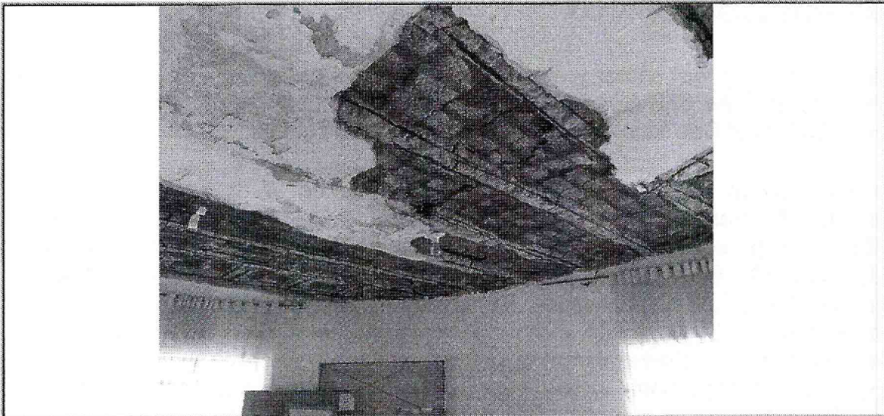
Foto No. 4. Se observa el desprendimiento del concreto que recubre el refuerzo metálico de la placa de cubierta perteneciente a la vivienda emplazada en el predio de la Calle 53B Sur # 29 – 06 ubicado en el Sector Catastral San Vicente Ferrer de la Localidad Tunjuelito.
