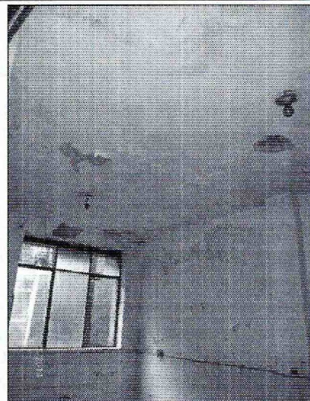
Fotografía 4. Humedades, deterioro en pintura y desprendimientos de mortero de cielo raso identificado al interior de la edificación ubicada en el predio de la Carrera 13A No. 32A-19, en el sector catastral Samper de la localidad de Santa Fe.
