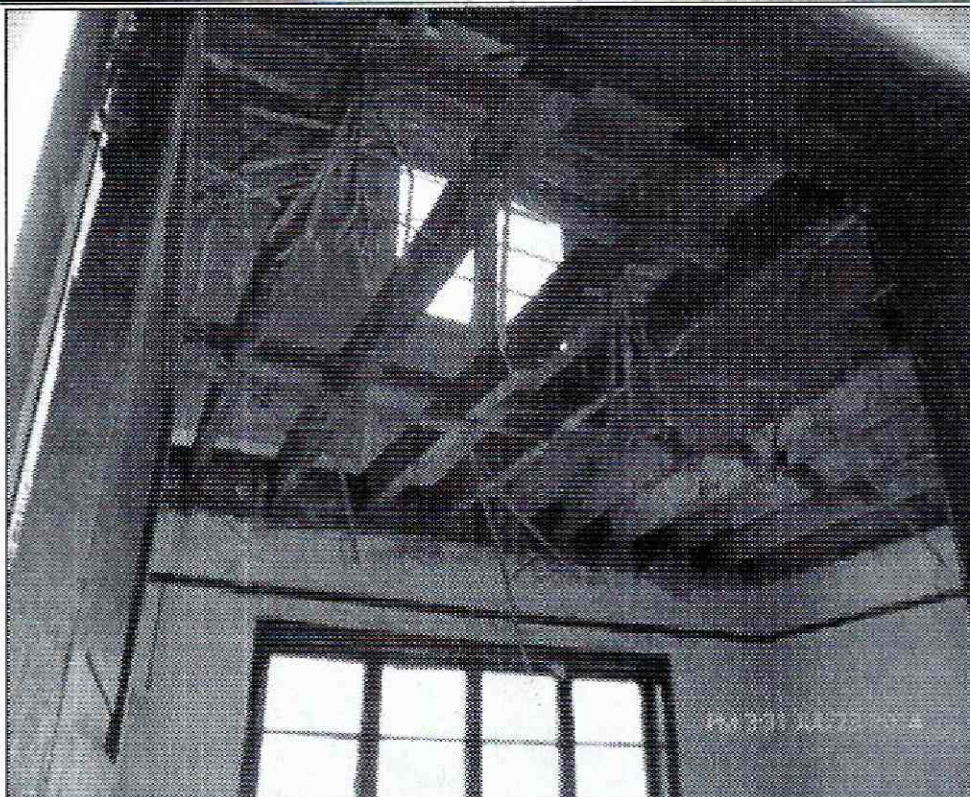
Fotografía 5. Entrepisos en vigería de madera, sin listonería transversal, en la edificación evaluada y ubicada en el predio de la Carrera 13A No. 32A-19, en el sector catastral Samper de la localidad de Santa Fe.
