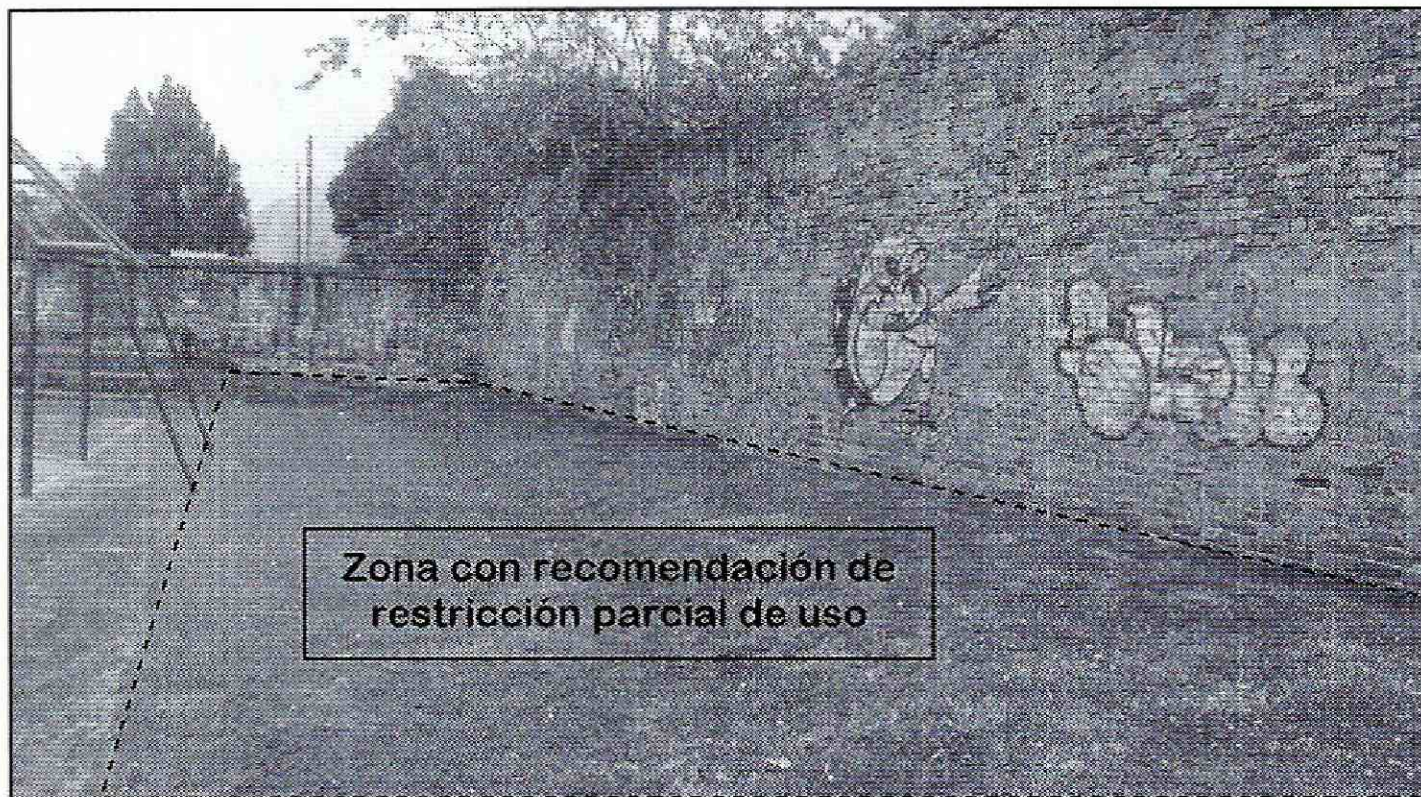
Fotografía 2. Vista del Muro de cerramiento costado oriental del Parque del Sector Catastral Sevilla ubicado en la Calle 2 Sur No.13A-16 del Sector Catastral La Hortúa de la Localidad de Antonio Nariño, donde se observa que en la totalidad de su luz no tiene confinamiento
