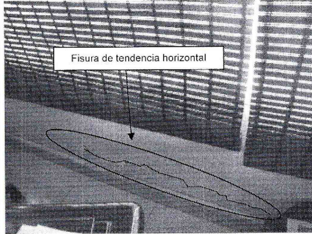
Foto 16. Fisura de tendencia horizontal evidenciada en el predio con nomenclatura "2. Carrera 9B # 117A-73" del Sector Catastral Santa Bárbara Central de la Localidad de Usaquén.
