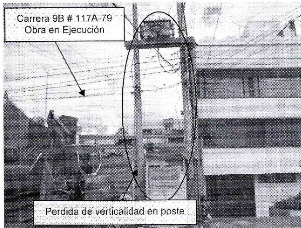
Foto 2. Vista general de predios con nomenclatura Carrera 9B # 117A-79 del Sector Catastral Santa Bárbara Central de la Localidad de Usaquén, donde adicionalmente se observa pérdida de verticalidad en poste de Codensa.
