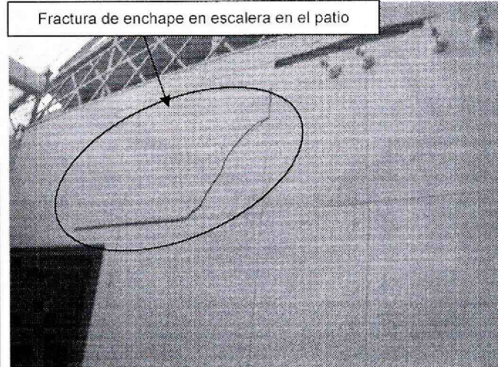
Foto 10. Fractura de enchape en el patio evidenciado en el predio con nomenclatura "1. Carrera 9B # 117A-71" del Sector Catastral Santa Bárbara Central de la Localidad de Usaquén.
