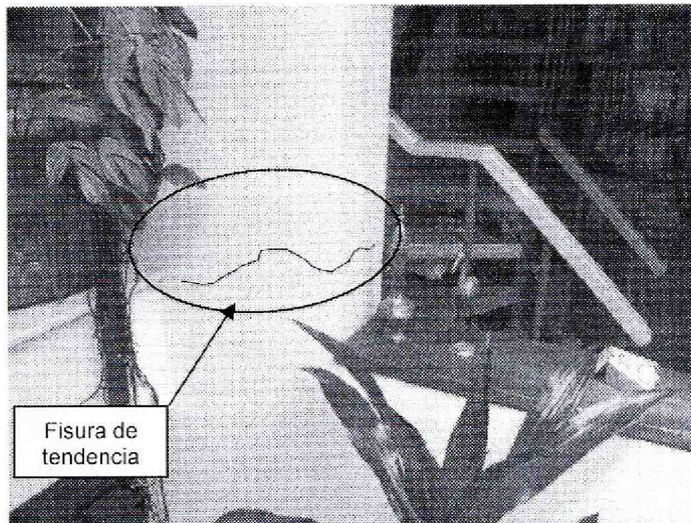
Foto 36. Fisura de tendencia horizontal evidenciada en el predio con nomenclatura 5. Carrera 9B # 117A-89 del Sector Catastral Santa Bárbara Central de la Localidad de Usaquén.
