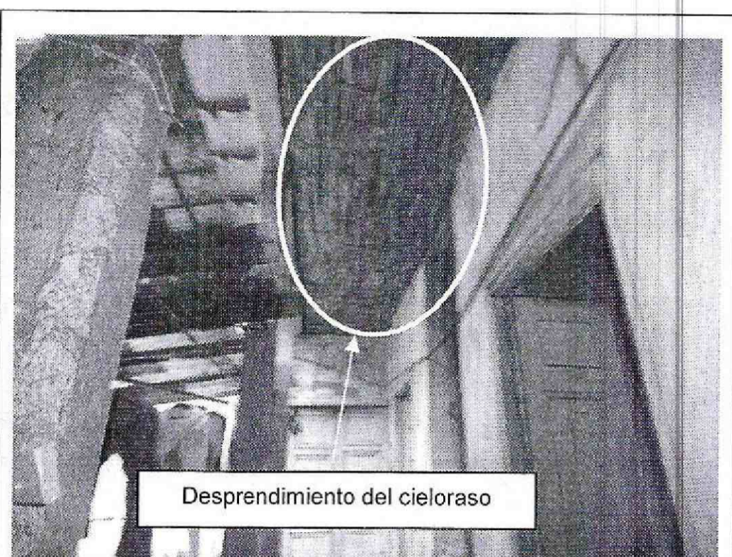
Foto 8. Desprendimiento del cieloraso evidenciado en un pasillo que conecta a varias habitaciones del predio de la Carrera 13 # 19-66 del Sector Catastral La Alameda de la Localidad de Santa Fe.
