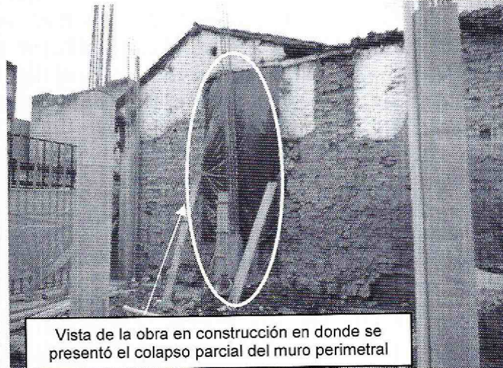
Foto 4. Vista de la obra en construcción en donde se presentó el colapso parcial del muro perimetral en el predio de la Carrera 13 # 19-52 del Sector Catastral La Alameda de la Localidad de Santa Fe.
