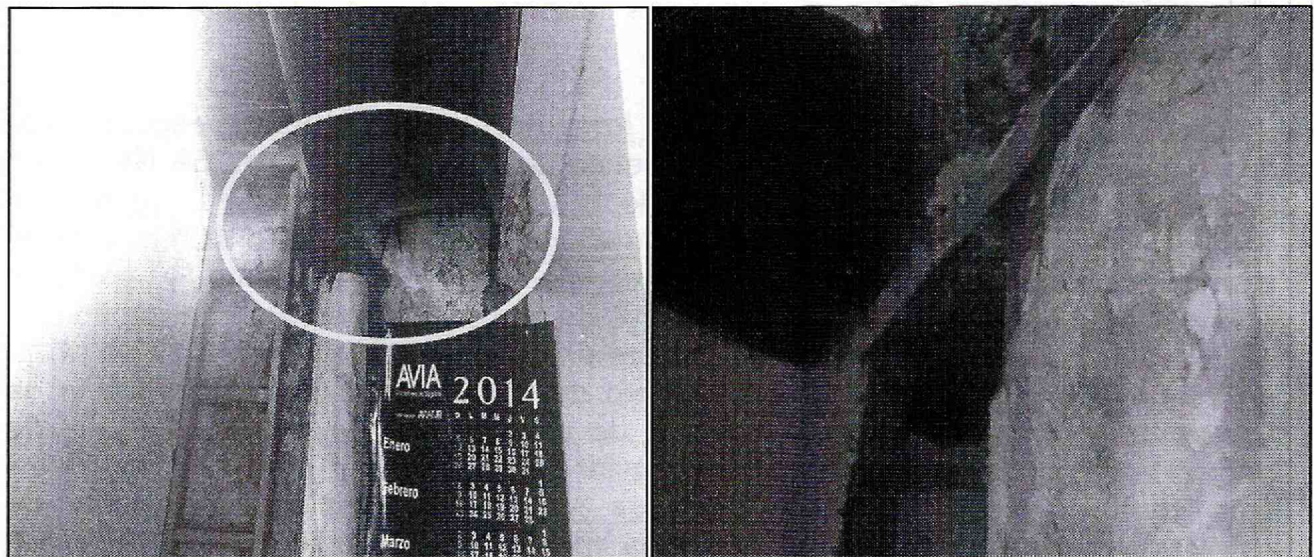
Fotografía 8 y 9. Humedades por filtración y deterioro general del predio de la Carrera 3A No. 31-61 del Sector Catastral La Perseverancia localidad de Santa Fe
