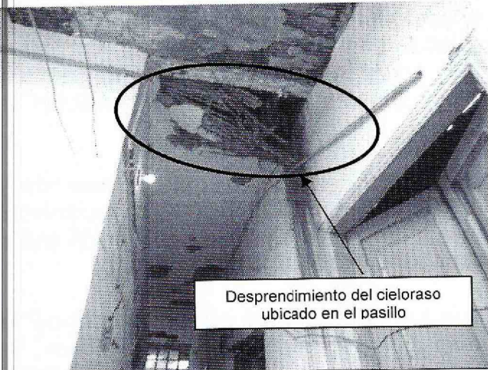
Foto 3. Desprendimiento de cieloraso en el pasillo que comunica las habitaciones ubicadas al costado nororiental del predio de la Calle 6A # 8A-20, el Sector Catastral Santa Bárbara de la Localidad de La Candelaria la cual genero el evento de emergencia.
