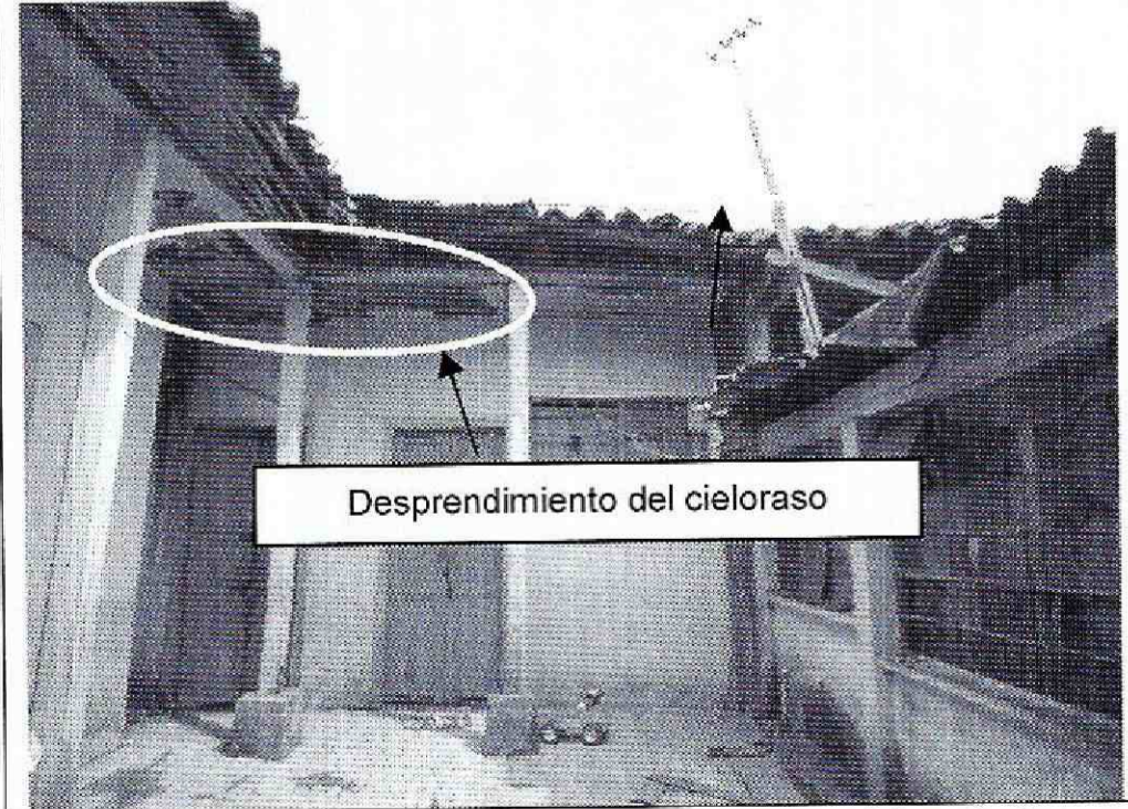
Foto 6. Desprendimiento del cieloraso evidenciado en el cieloraso del predio de la Calle 6A # 8A-20, el Sector Catastral Santa Bárbara de la Localidad de La Candelaria
