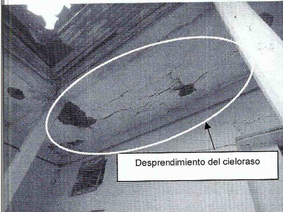
Foto 5. Desprendimiento del cieloraso evidenciado en el cieloraso del predio de la Calle 6A # 8A-20, el Sector Catastral Santa Bárbara de la Localidad de La Candelaria
