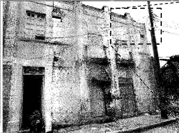
Foto 3. Vista general de la fachada principal (costado occidental) de la edificación emplazada en el predio de la Carrera 11 No. 5-56. Donde se observa deterioro de elementos estructurales y no estructurales.
