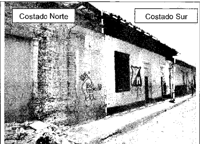
Foto 6. Vista general de la fachada principal (costado norte y sur) de la edificación emplazada en el predio de la Carrera 11 No. 5-40/46. Donde se observa colapsos de cubierta y muros del costado norte.
