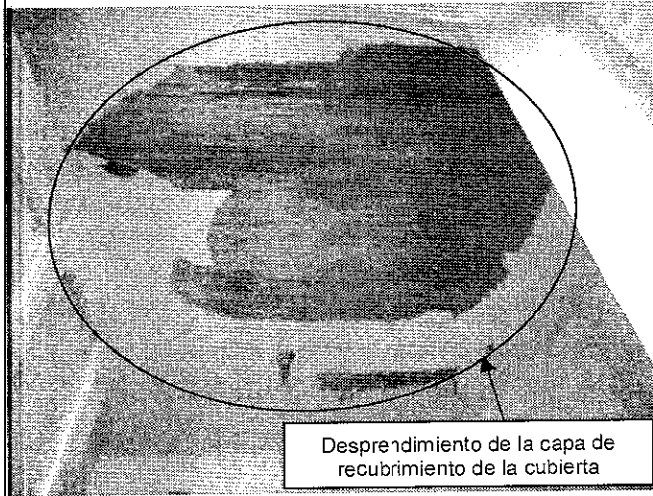
Foto 3. Desprendimiento de la capa de recubrimiento de la cubierta de una habitación ubicada al costado norte del predio de la Carrera 27 # 50-30 del Sector Catastral Alfonso López en la Localidad de Teusaquillo
